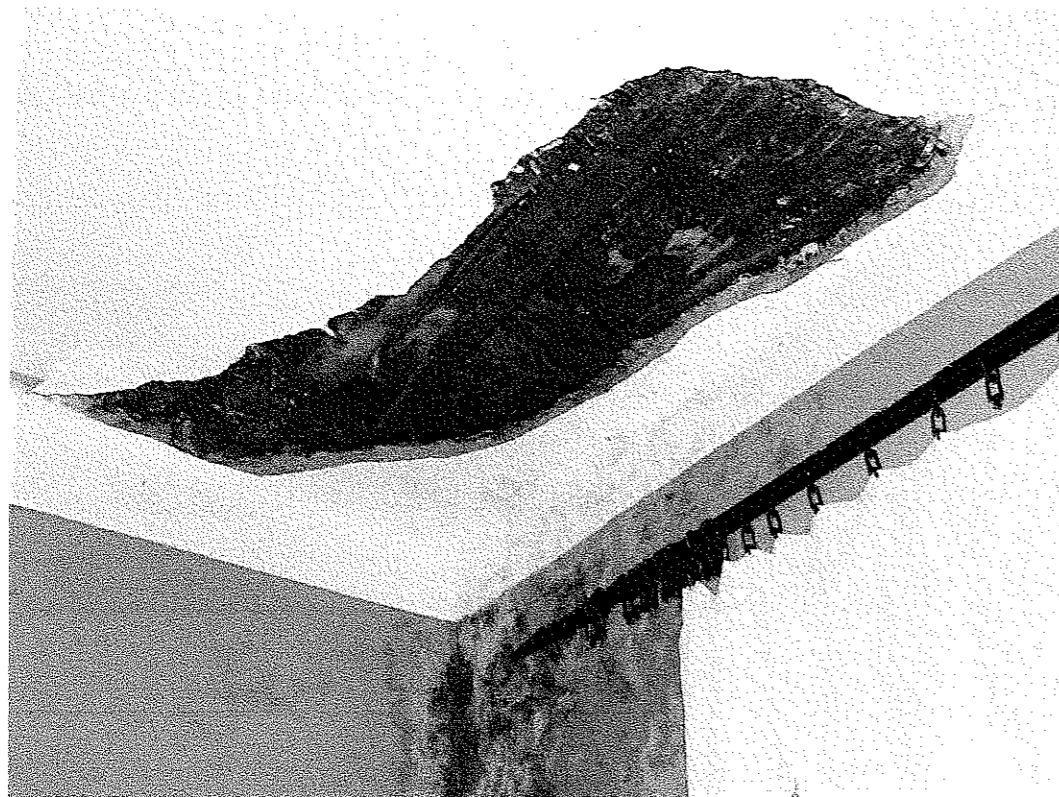
Zdjęcie nr 2 – Uszkodzone belki stropowe i zawilgocenia ścian na II piętrze
