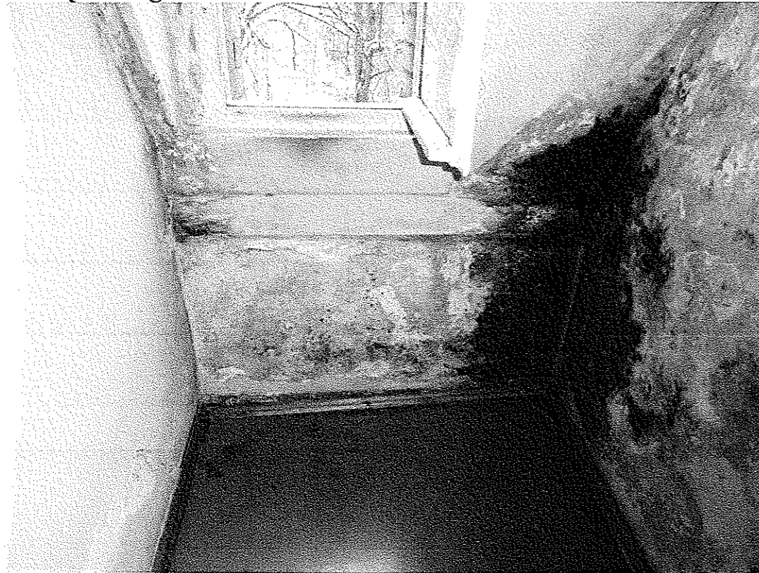
Zdjęcie nr 1 – Zawilgocona ściana na poddaszu
