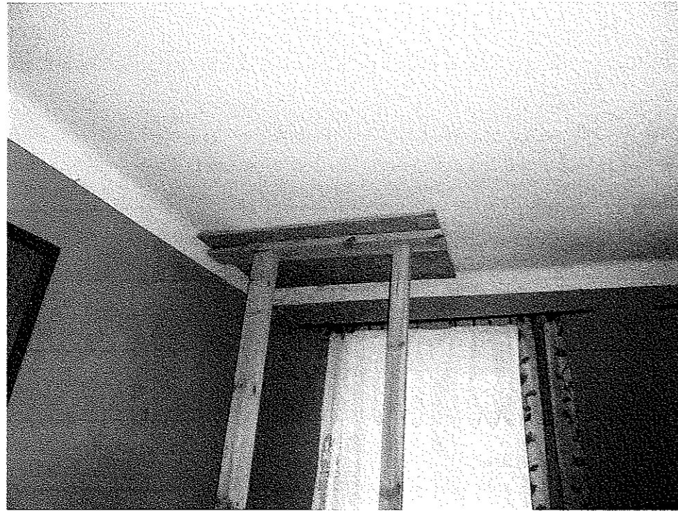
Zdjęcie nr 4 – Stan obecny – podstemplowany strop
